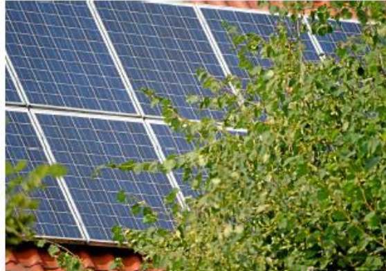
Die Stadt Herzberg hat im Rahmen des örtlichen Klimaschutzkonzeptes bereits mehrere PV-Anlagen auf städtischen Gebäuden installiert. Bei der regenerativen Stromerzeugung liegt die Stadt Herzberg mit rund zehn Prozent aber noch deutlich unter dem Bundesdurchschnitt von über 40 Prozent, meint Dipl.-Ing. Benedikt Siepe.
